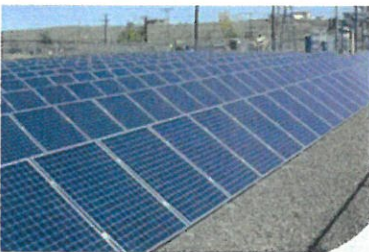
インド 33 MWp 2011年
