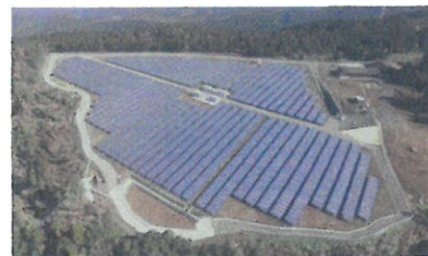
CSJ芦北発電所(熊本県葦北郡芦北町) 2.3MW 2015年
