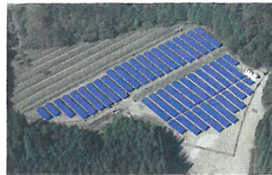
兵庫県朝来市 652.8kWp 2014年
