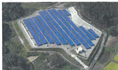
CSJ伊佐市発電所(鹿児島県伊佐市) 0.86MW 2015年
